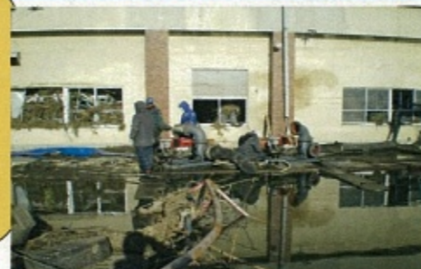
排水機場被災状況（寺野地区）
