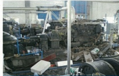
排水機場被災状況（閉上地区）
